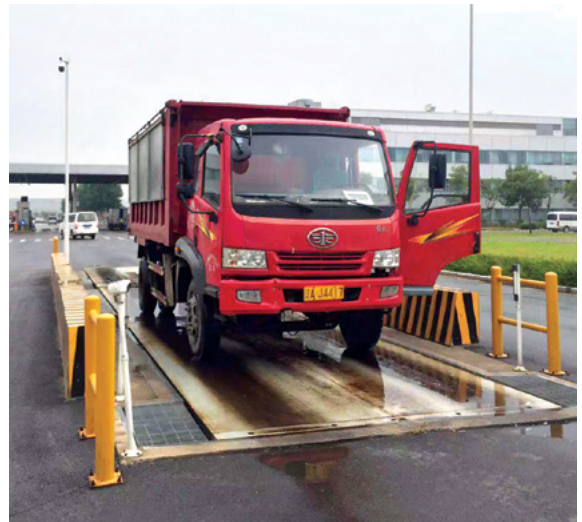
新安装的废弃物称重系统。
